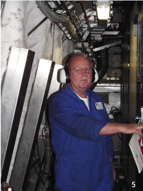
Ruimte naar LM2500 module BB
